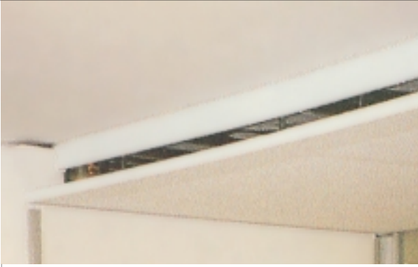
Lufteintritt im Deckenbereich
