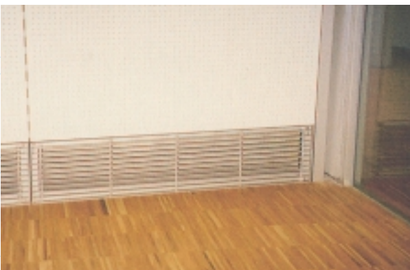
Luftaustritt im Fußbodenbereich
